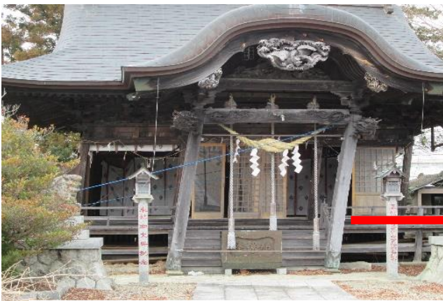
地震で傾いた本殿
