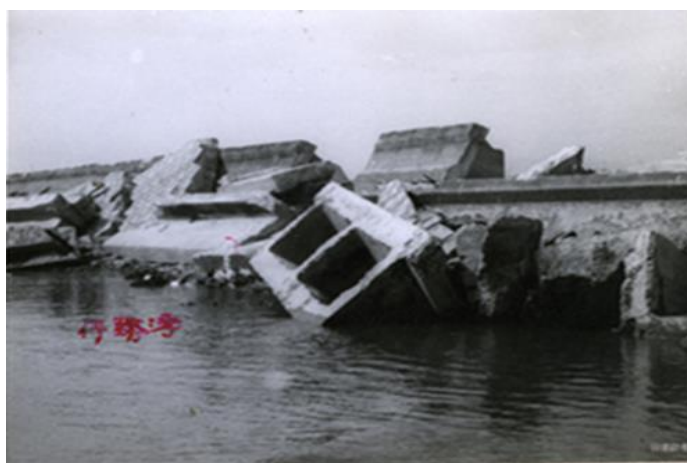
破壊された弥富市鍋田干拓海岸堤東側の堤防基礎 出典：国土交通省 木曾川下流河川事務所 (旧建設省 撮影)
